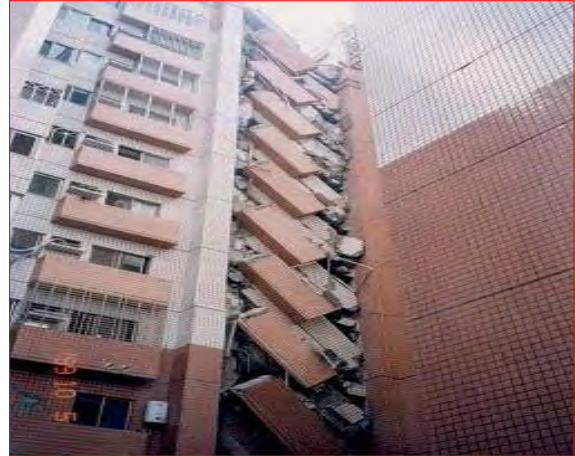
[건물사이 연결된 건물의 붕괴(대만)]
